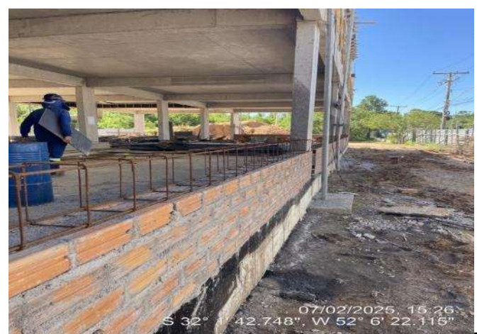
Contravergas (Térreo Ala Leste);
