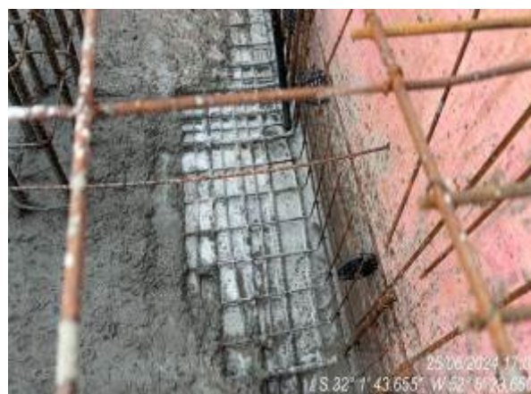
Excesso de água mistura ao concreto do bloco 39
