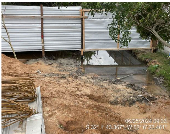
Água ultrapassando os tapumes da obra
