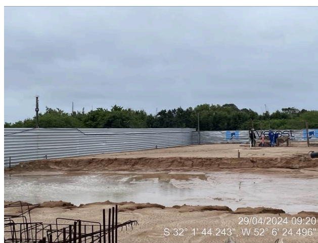
Geral canteiro – execução prejudicada pós ocorrência de chuva
