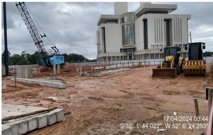
Geral canteiro – execução prejudicada pós ocorrência de chuva
