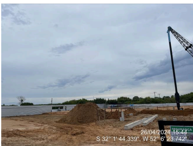
Leitura dos Equipamentos de Monitoramento
