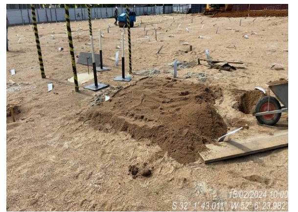
Execução de base no nível correto do colchão de areia para instalação das placas de monitoramento do recalque
