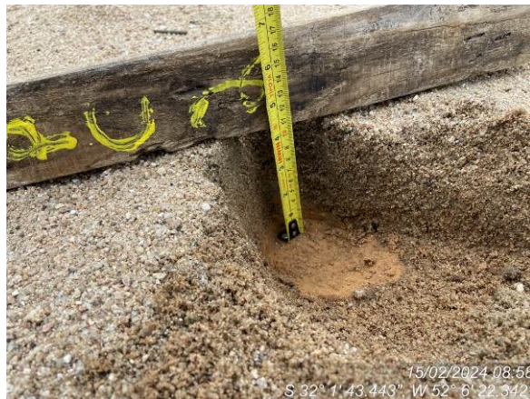
Colchão de areia com altura inferior ao projetado.
