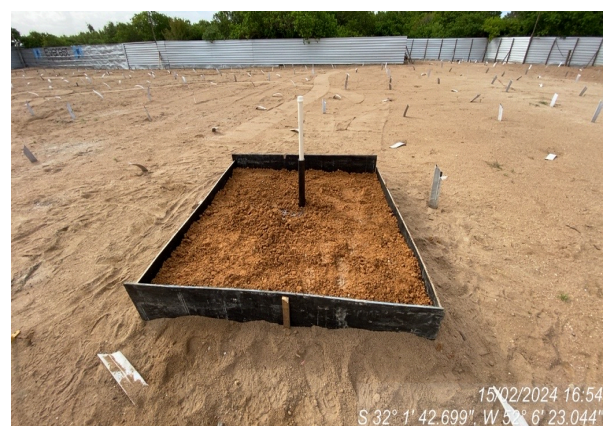
Placa de monitoramento de recalque instalada
