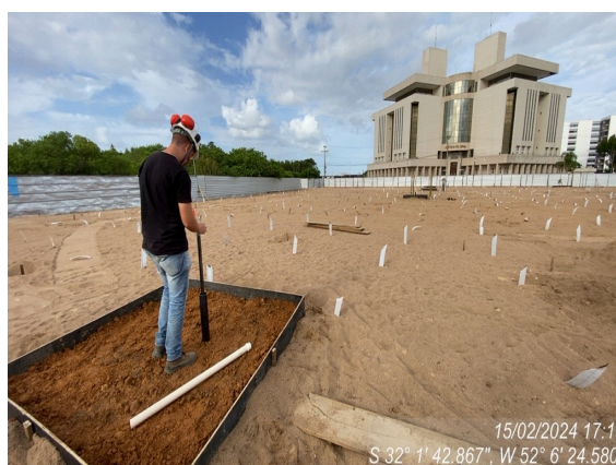
Leitura do nível inicial da placa de monitoramento de recalque
