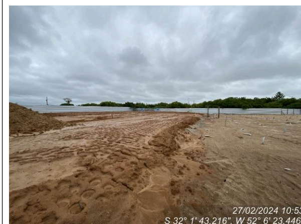
Aterro de sobrecarga pós chuva
