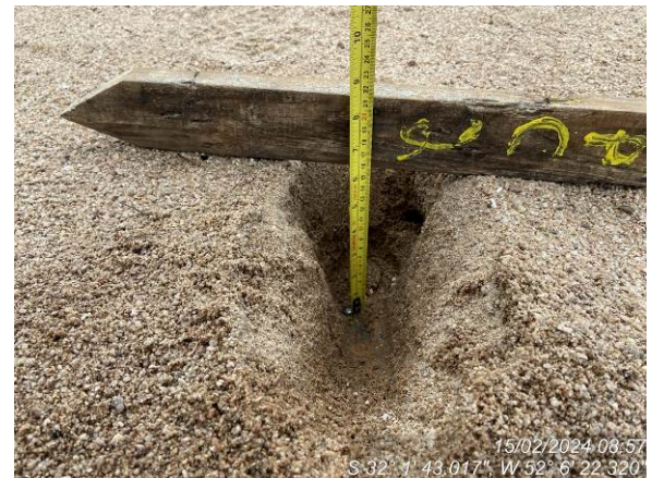
Colchão de areia com altura inferior ao projetado
