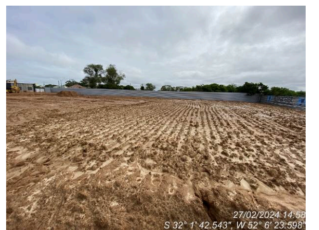
Aterro de sobrecarga pós chuva
