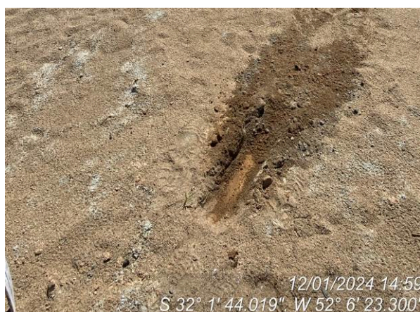
Colchão de areia com espessura menor que a prevista em projeto
