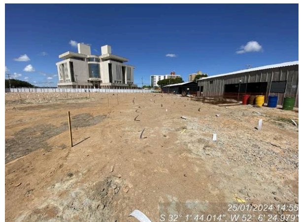
Colchão de areia não executado
