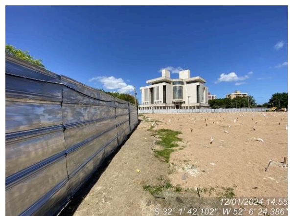
Colchão de areia não executado
