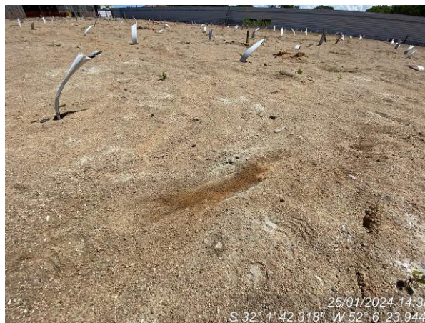
Colchão de areia com espessura menor que a prevista em projeto
