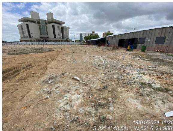
Colchão de areia não executado
