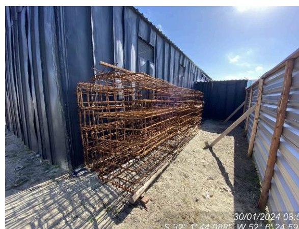
Armaduras dos blocos de fundação – único serviço executado durante o mês de janeiro.
