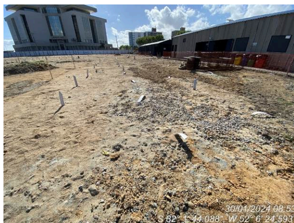
Colchão de areia não executado
