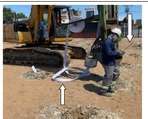
Geodreno que não ficou no solo após o retorno da lança – operador já com facão em mãos para realizar o corte do geodreno – não ocorreu o levantamento da quantidade de geodreno que retornou
