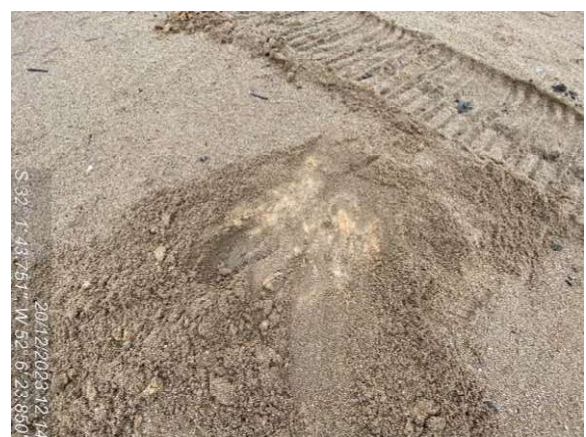
Espessura do colchão de areia executado, menos de 5 cm.
