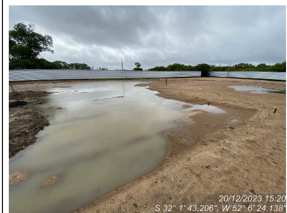
Água acumulada no canteiro
