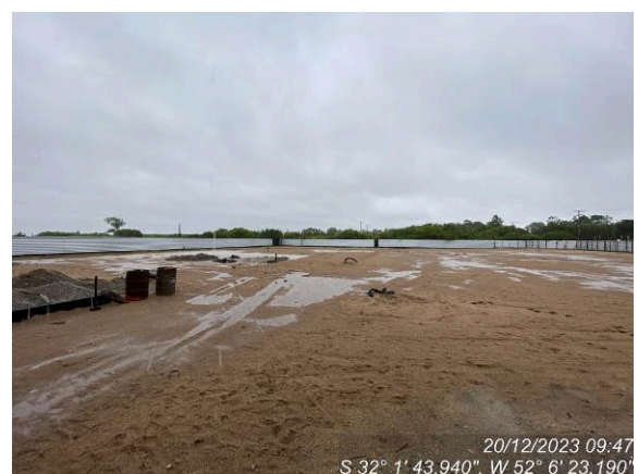
Água acumulada no canteiro durante a ocorrência de chuva
