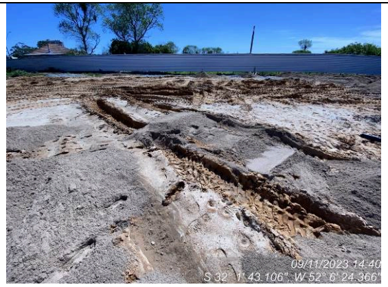
Dia 09/11 – Areia misturada ao aterro com problemas de compactação
