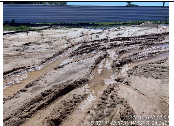
Dia 24/11 – Aterro com muita água acumulada – consistência de lama na presença de água
