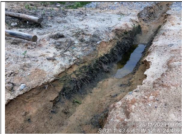
Dia 28/11 – Espessa camada vegetal não removida durante a decapagem do terreno
