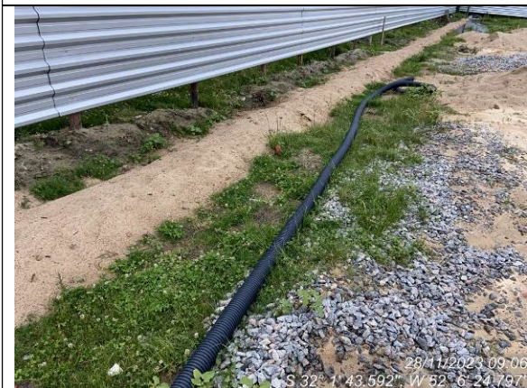
Dia 28/11 – Drenagem subsuperficial executada sem a devida decapagem do terreno
