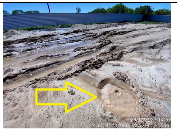
Dia 24/11 – Local que foi realizado ensaio de compactação, após ocorrência de chuva compactação foi perdida
