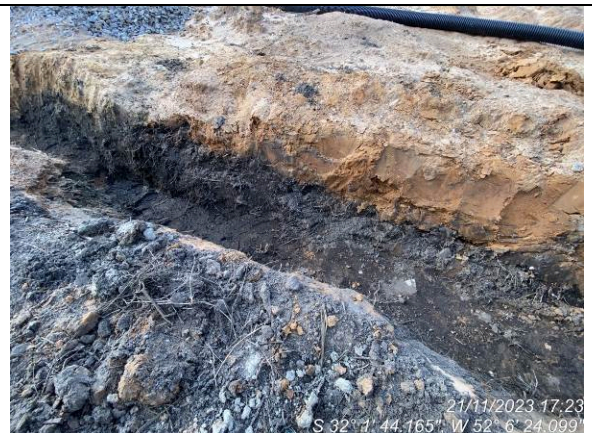
Dia 21/11 – Espessa camada vegetal não removida durante a decapagem do terreno
