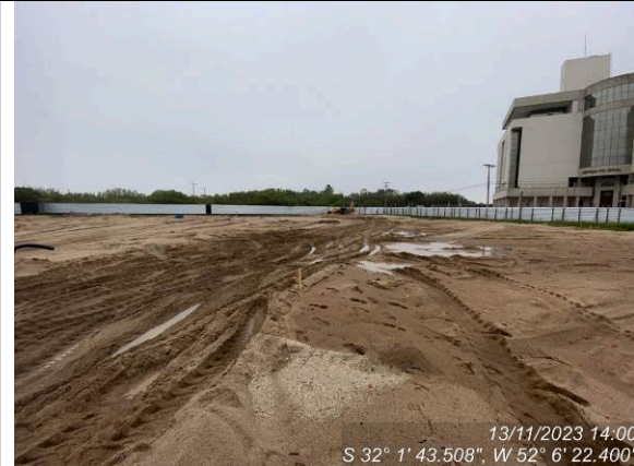
Dia 13/11 – Água acumulada no canteiro
