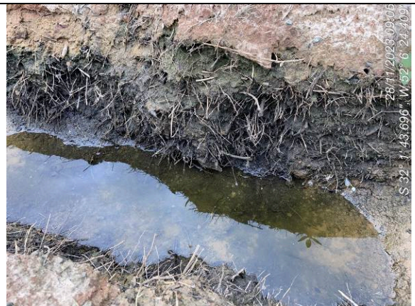
Dia 28/11 – Camada vegetal não removida durante a decapagem do terreno
