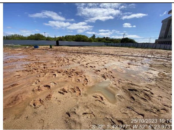
Dia 25/10 – Aterro de regularização com muita água acumulada – consistência de lama na presença de água
