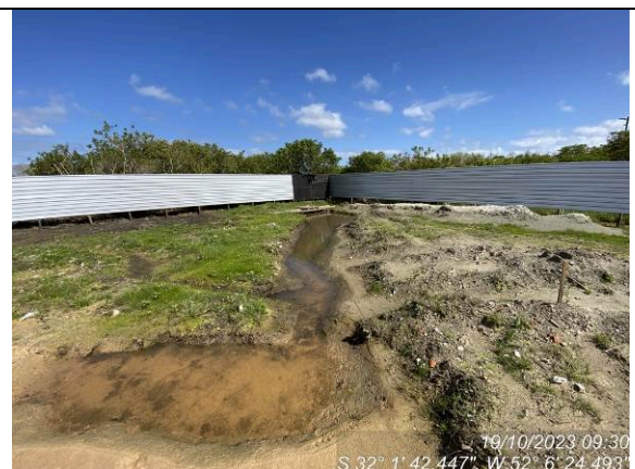
Dia 19/09 – Água acumulada no canto noroeste do canteiro
