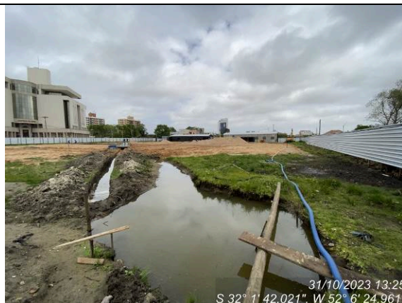
Dia 31/10 – Água acumulada no canto noroeste do canteiro
