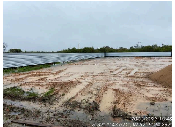
Dia 26/09 – Água da chuva acumulada no canteiro
