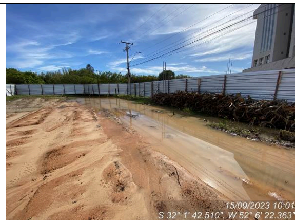
Dia 15/09 – Água da chuva acumulada no canteiro
