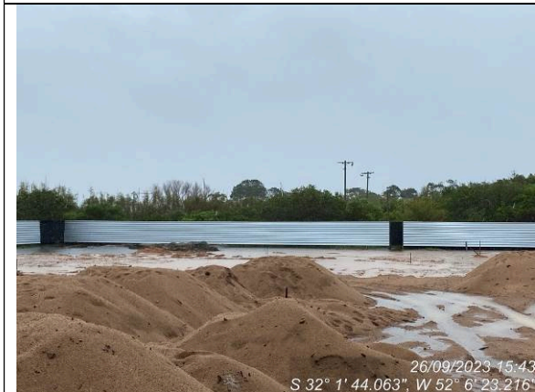
Dia 26/09 – Água da chuva acumulada no canteiro
