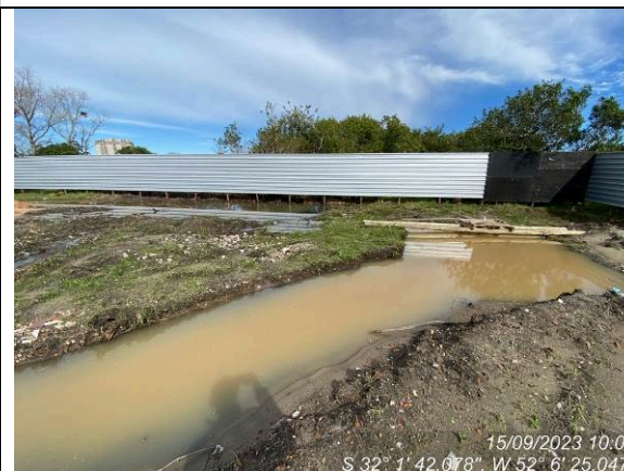
Dia 15/09 – Água da chuva acumulada no canteiro
