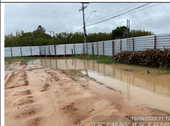
Dia 19/09 – Água da chuva acumulada no canteiro
