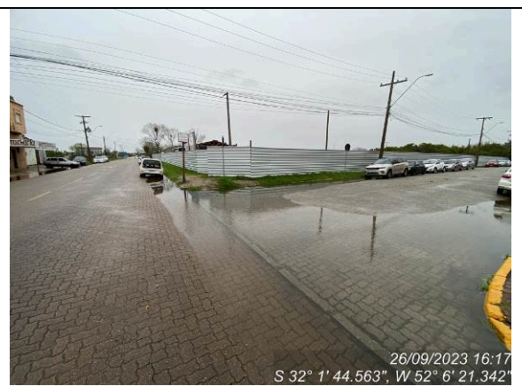
Dia 25/08 – Água saindo pela boca-de-lobo da esquina da obra
