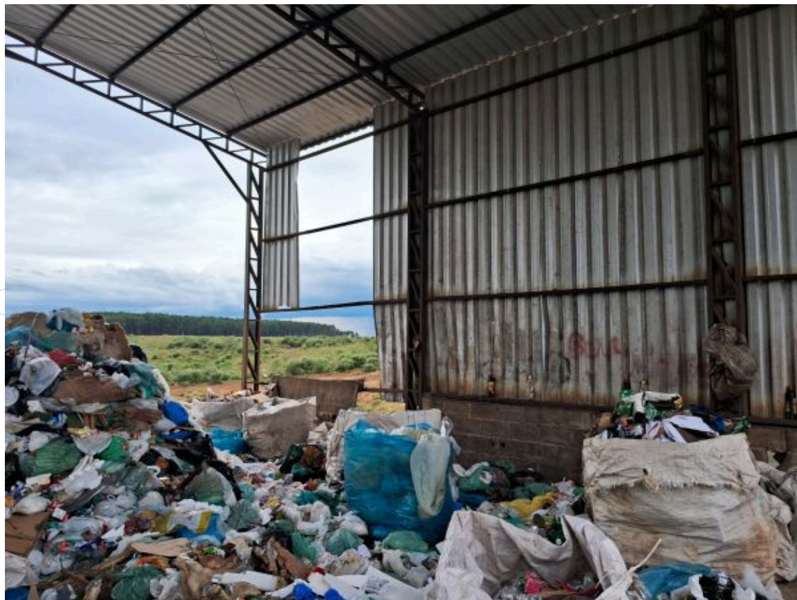
Faltavam telhas na lateral e no teto, e chuva penetrava no ambiente, molhando o lixo e os trabalhadores. Foto: MTE-RS
