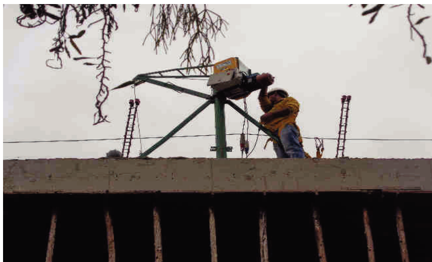
Laje da cobertura sem guarda-corpo
