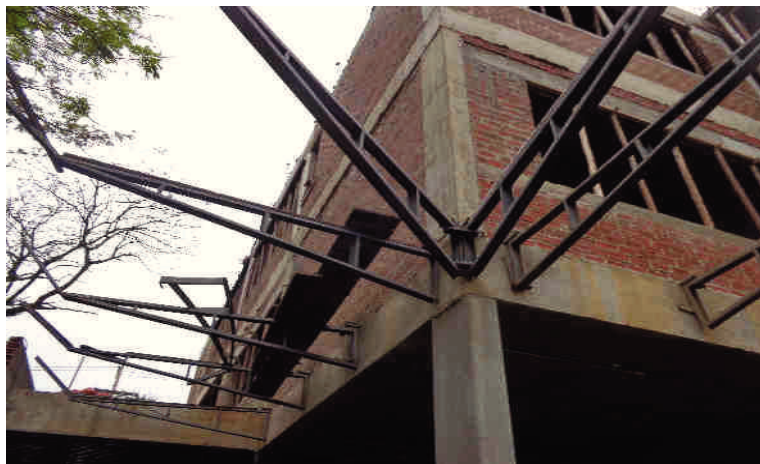
Bandeja salva-vidas não instaladas
