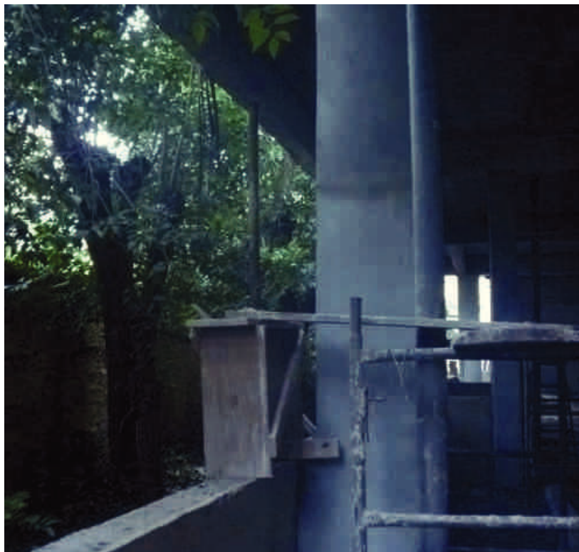
Foto 25 – Térreo. Estrutura utilizada nas linhas de vida
