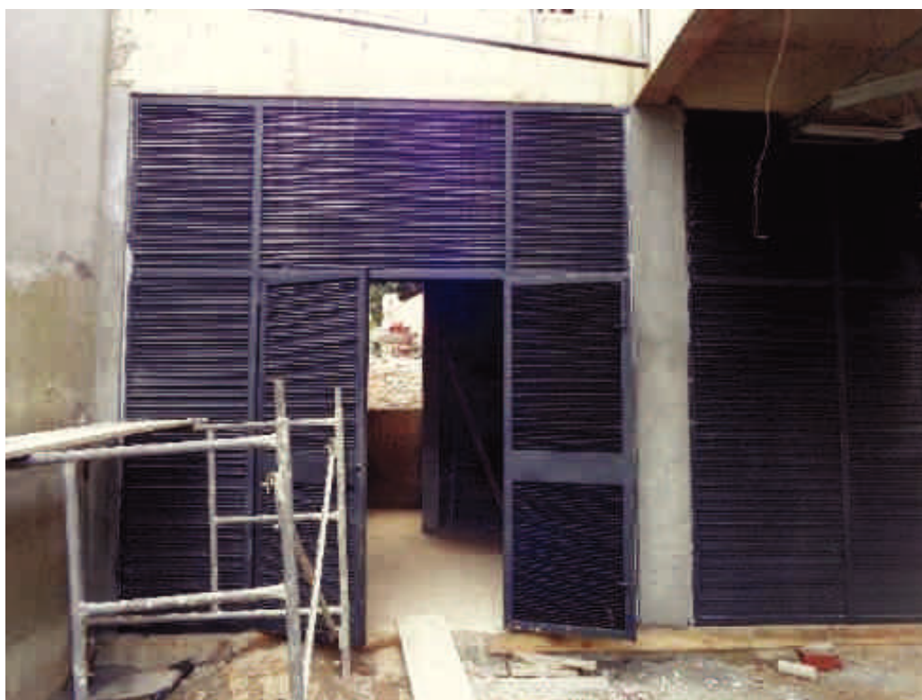
Foto 10 – Subsolo – Acesso à subestação
