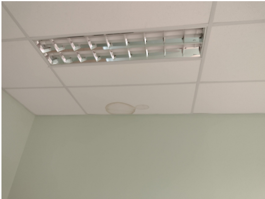
Foto 17 - Infiltração no forro da Sala de Conciliação
