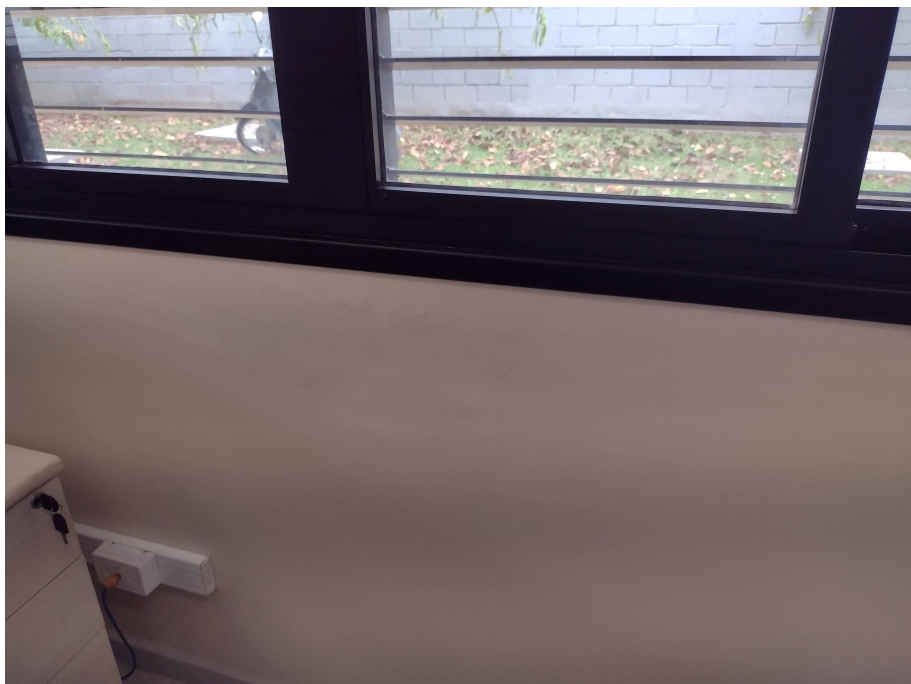
Foto 12 - Patologia na pintura (bolhas) na janela da Secretaria
