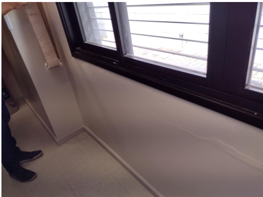
Foto 08 - Patologia na pintura (bolhas) na janela do Arquivo
