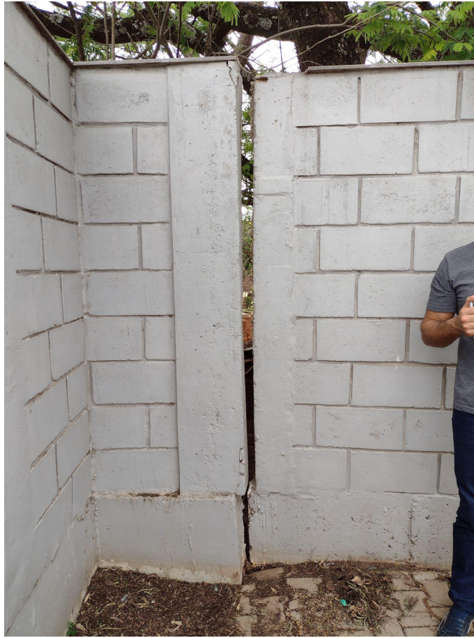
Foto 23 - Muro nos fundos da Vara do Trabalho (detalhe do deslocamento/abertura)
