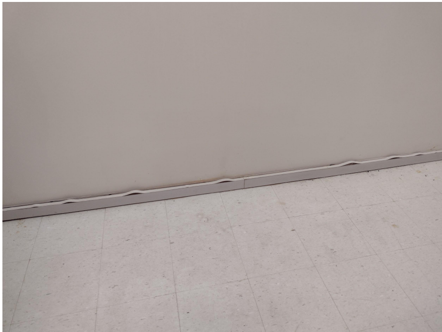
Foto 21 - Rodapé da Sala da OAB danificado pela infiltração
