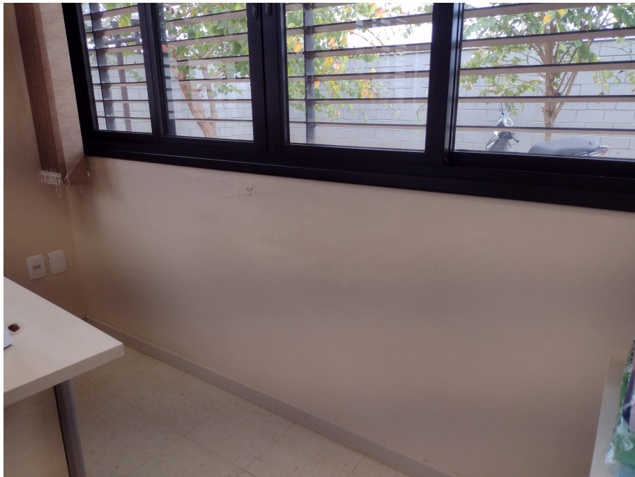
Foto 11 - Patologia na pintura (bolhas) na janela da Secretaria
