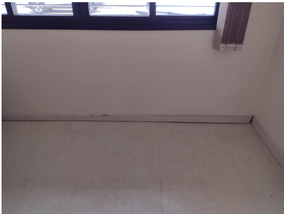
Foto 14 - Patologia na pintura (bolhas) na janela e rodapé danificado pela infiltração na Sala dos Assessores
