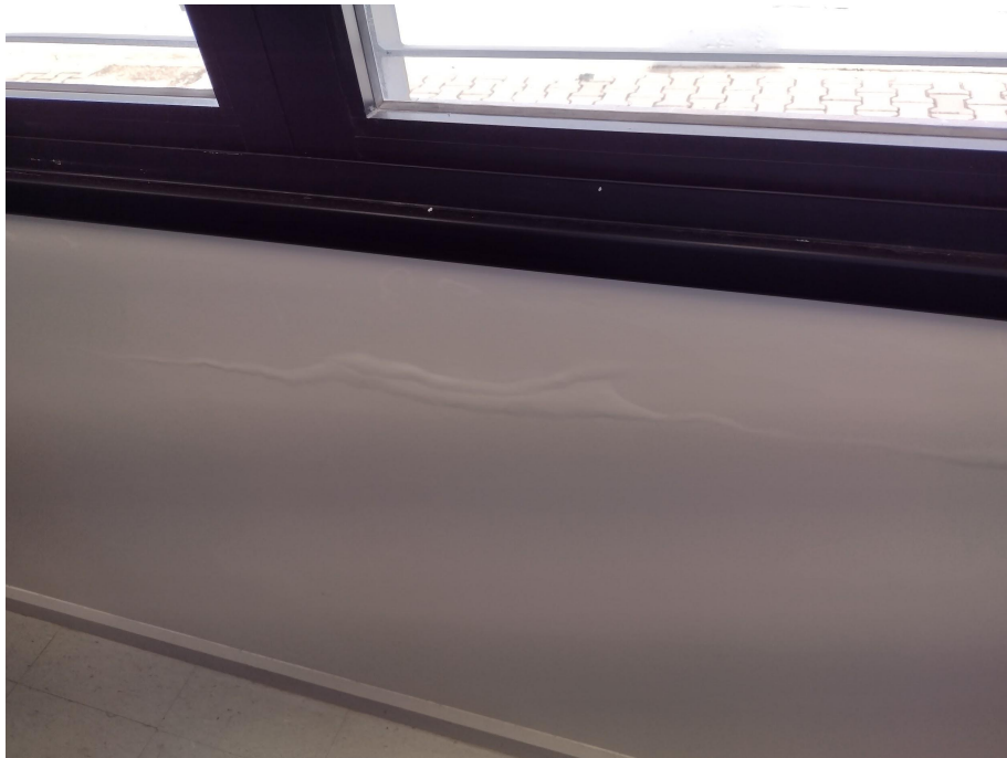
Foto 09 - Patologia na pintura (bolhas) na janela do Arquivo
