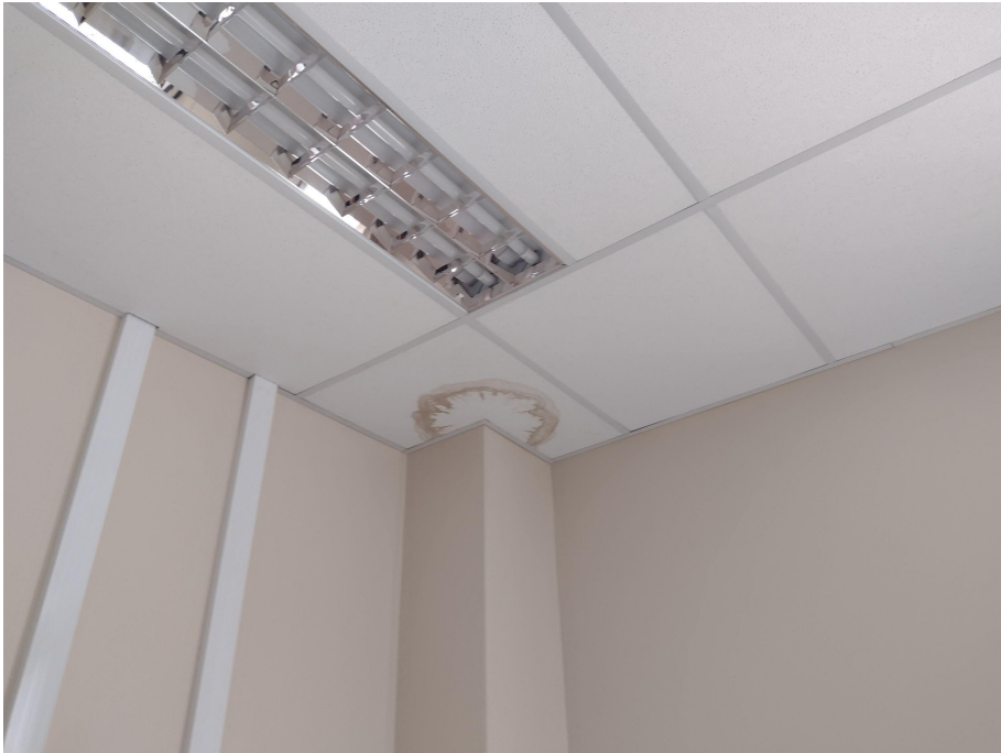
Foto 19 - Infiltração no forro da Sala dos Vigilantes
