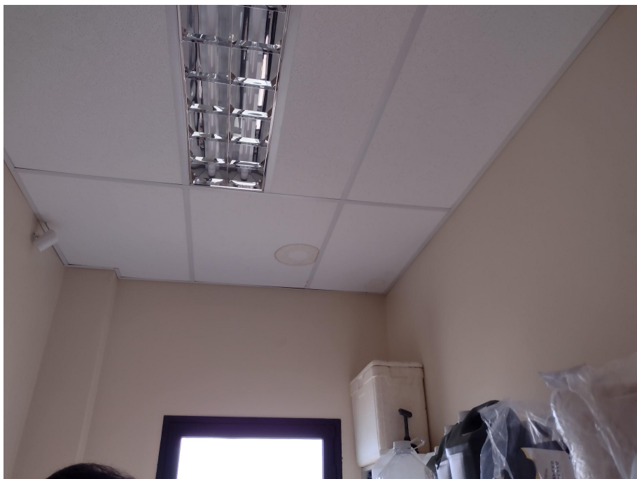
Foto 16 - Infiltração no forro da Sala do DML
