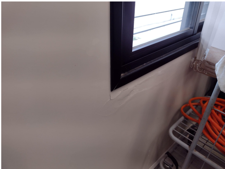
Foto 10 - Patologia na pintura (bolhas e descascamento/descolamento da tinta) na janela do Arquivo
