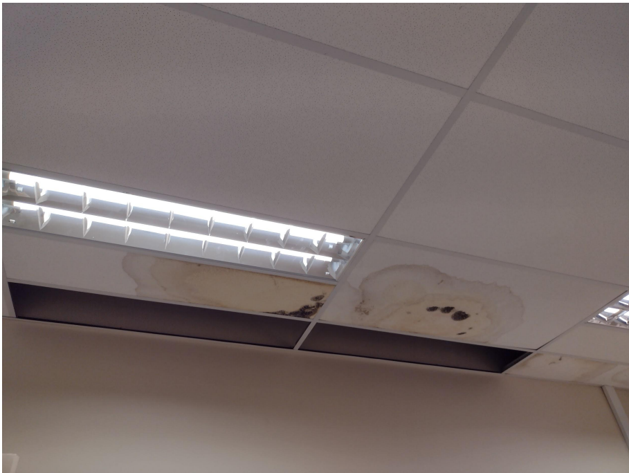
Foto 20 - Infiltração no forro da Sala da OAB
