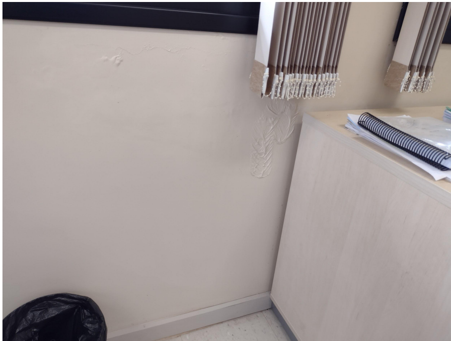
Foto 13 - Patologia na pintura (bolhas) na janela da Secretaria
