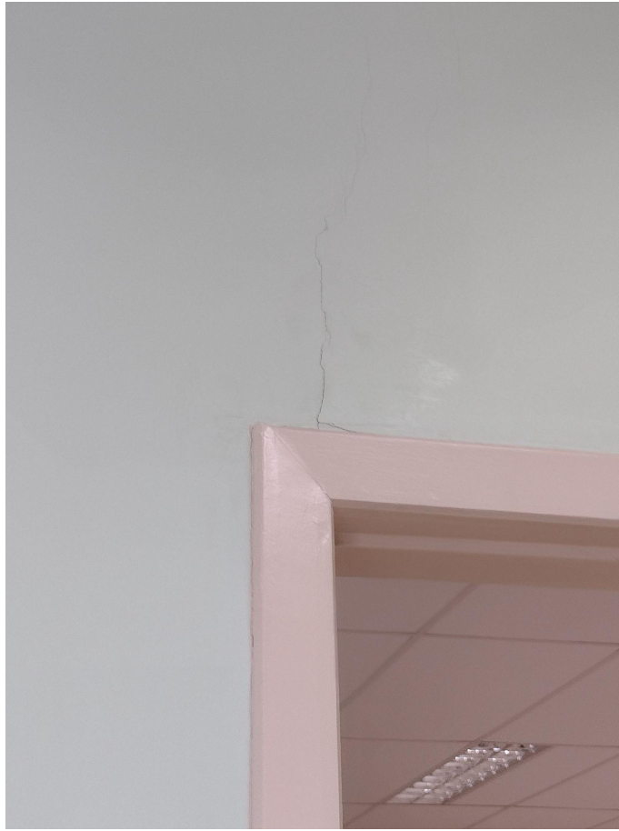
Foto 26 - Rachadura na parede, acima da porta da Sala de Audiência
