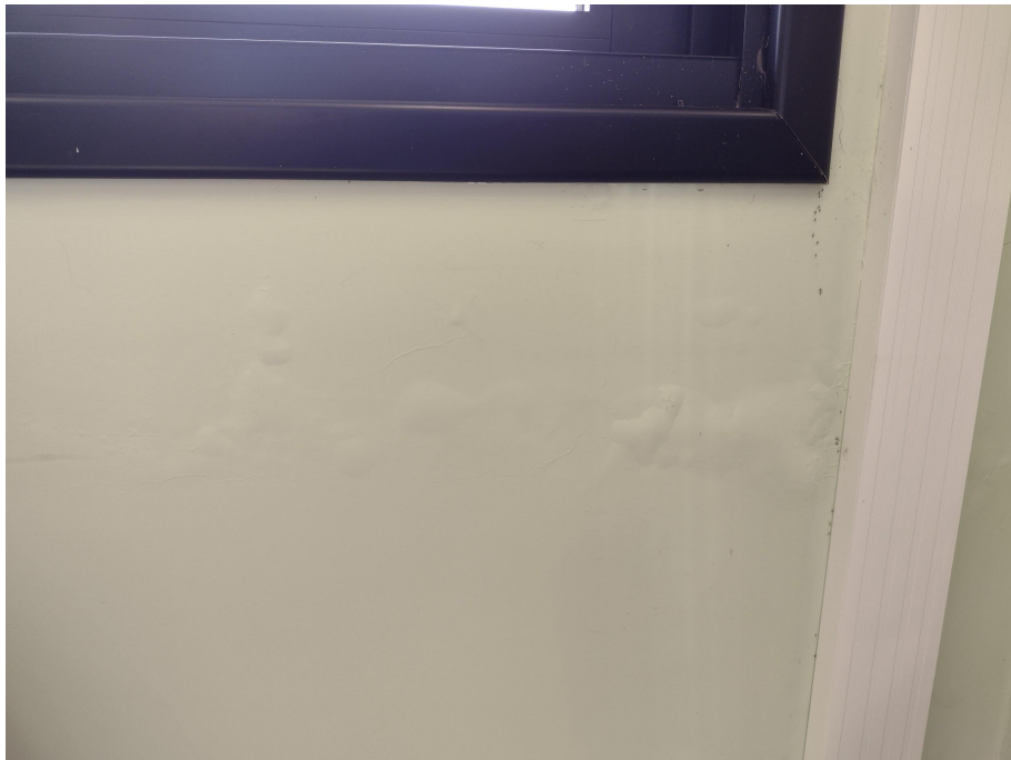
Foto 07 - Patologia na pintura (bolhas) na janela da Sala de Audiência
