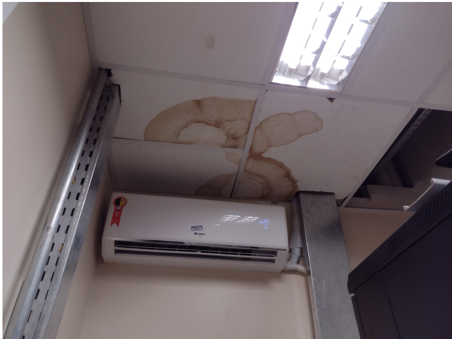
Foto 15 - Infiltração no forro da Sala do CPD
