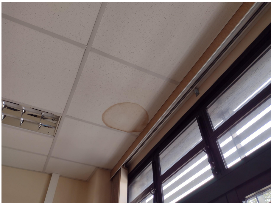
Foto 18 - Infiltração no forro da Sala dos Assessores
