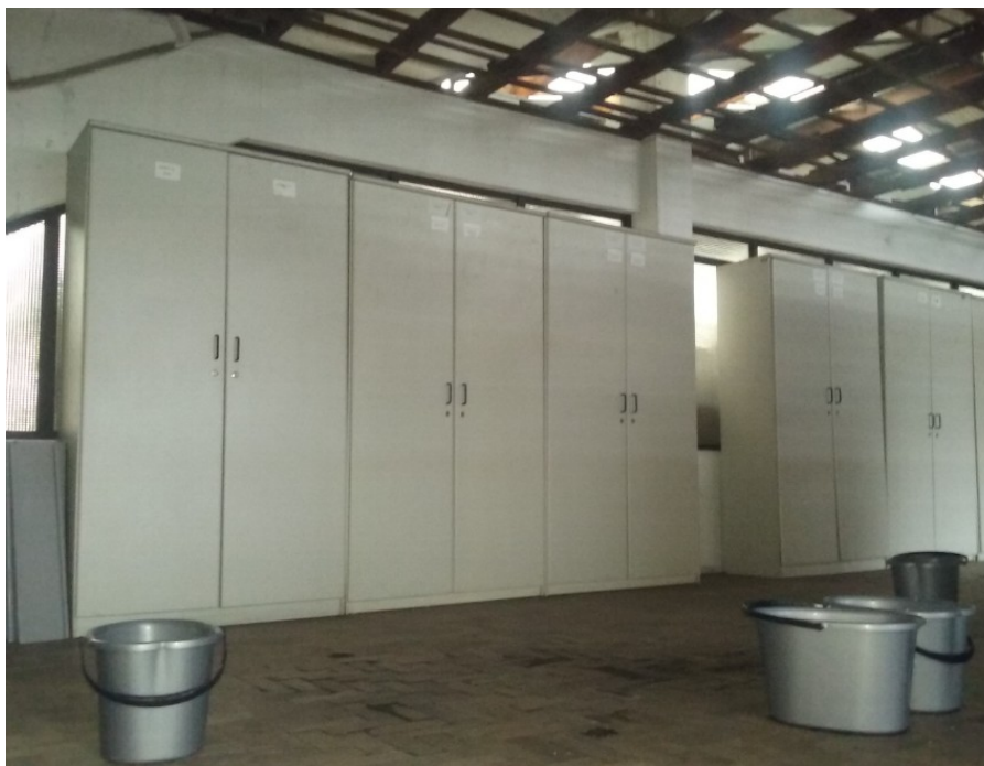
Foto 7: Sinais de goteiras em espaços nos galpões do Depósito Centralizado
