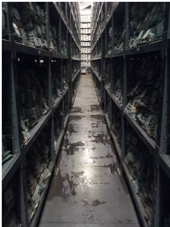
Foto 3: Presença de intensa umidade no piso dos galpões do Depósito Centralizado
