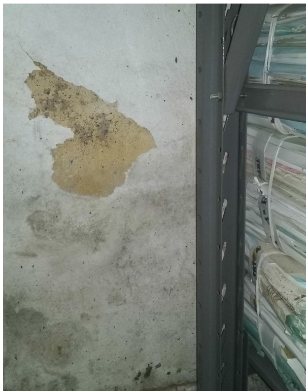
Foto 5: Sinais de presença de umidade, muito próximo aos processos, em algumas paredes dos galpões do Depósito Centralizado
